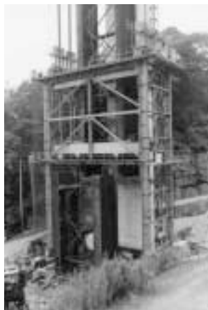
Photo 9 ジャッキアップ施工状況ジャッキアップ後及び桁挿入前
