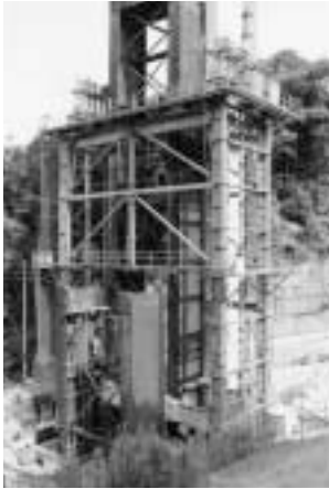
Photo 8 ジャッキアップ施工状況桁組立及びジャッキアップ前
